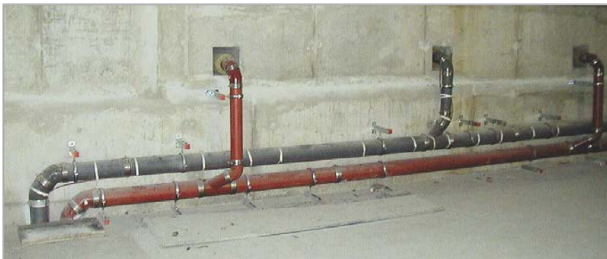
Gusseiserne Abflussrohre im Einsatz (Bild: SAINT-GOBAIN HES) oben: PAM-GLOBAL® Plus (KML)-Rohr für aggressive Abwässer unten: PAM-GLOBAL® S (SML)-Rohr für häusliche Abwässer
